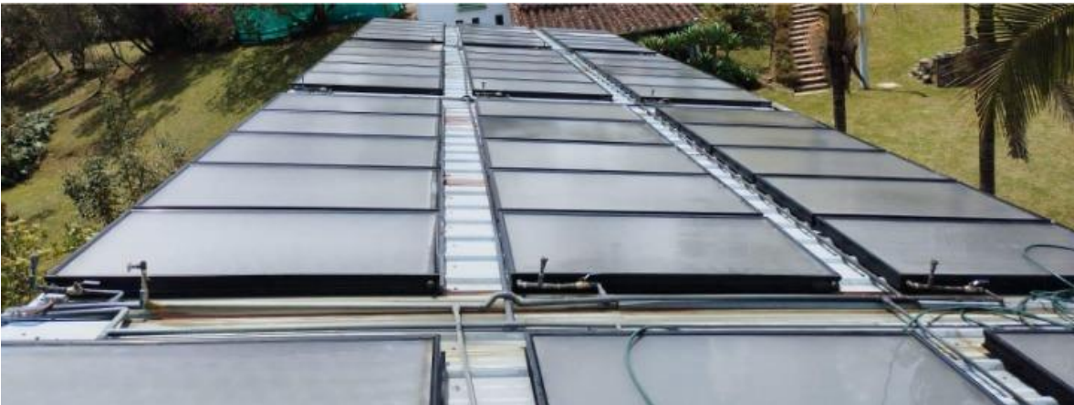
Ilustración 23: Sistema de colectores solares térmicos de placa plana Fuente propia
