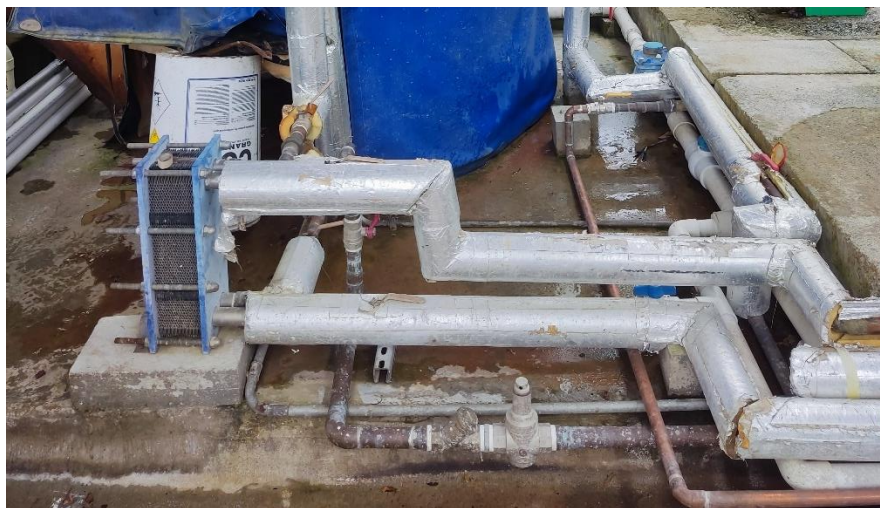
Ilustración 33: Intercambiador de placas. Fuente propia
