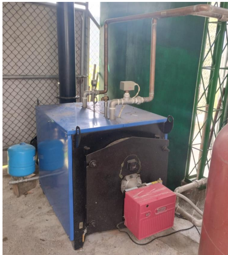
Ilustración 25: Caldera de gas presente en el Eco Hotel Piedras Blancas. Fuente propia
