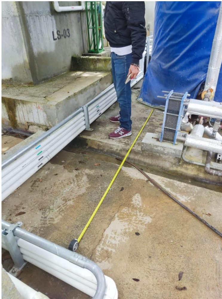
Ilustración 24: Toma de medidas para posible ubicación de bombas de calor. Fuente propia
