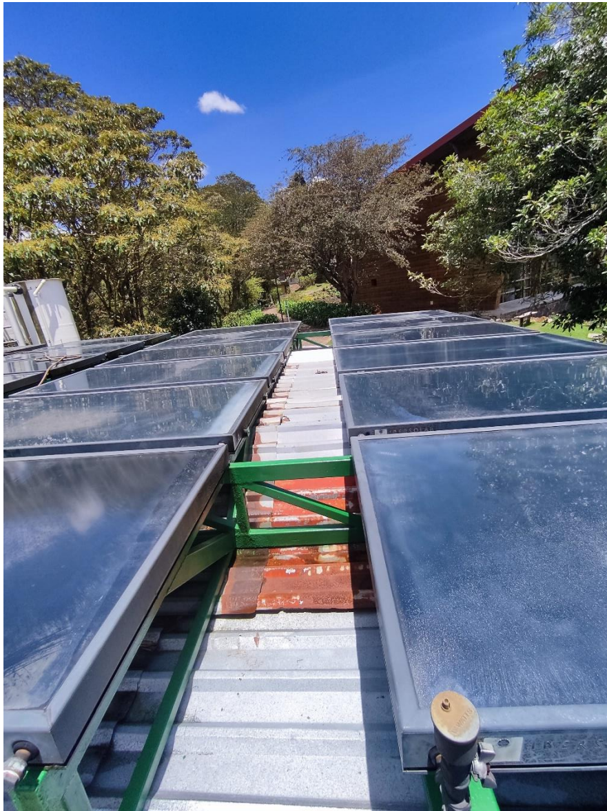
Ilustración 22: Colectores solares térmicos de placa plana Fuente propia
