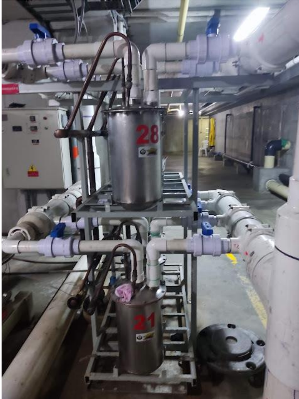
Ilustración 13: Rack de intercambiadores de calor en titanio Fuente propia
