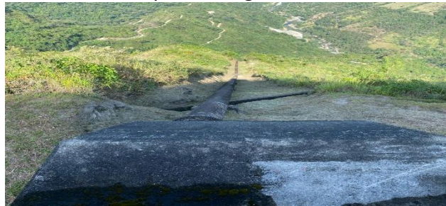
Sistema de tubería a la salida del tanque de carga
