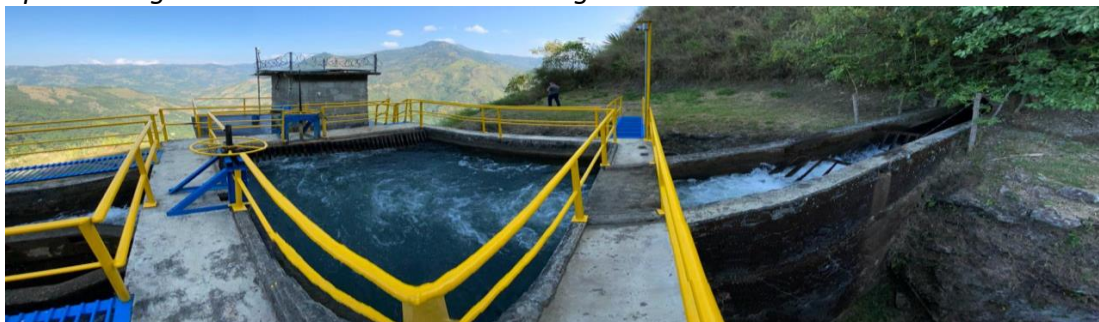
Tanque de carga de la central hidroeléctrica Yeguas
