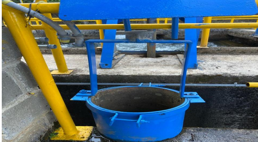
Almenara de la central hidroeléctrica Yeguas
