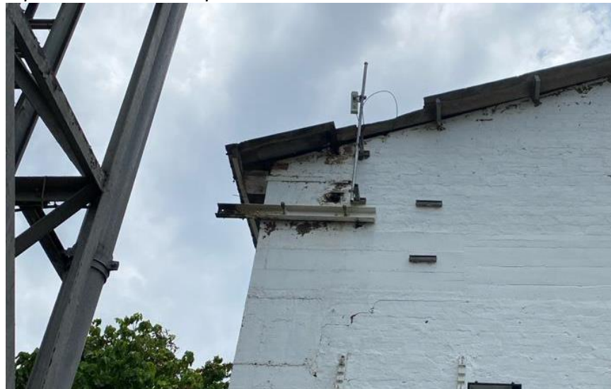
Antena y receptor de casa de máquinas
