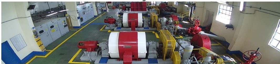
Turbinas Pelton de la central hidroeléctrica Yeguas
